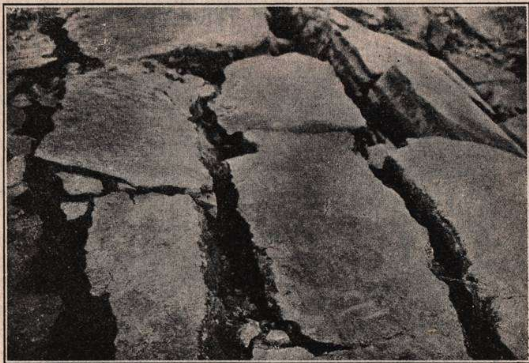
Fig. 454.—Enormes grietas producidas cerca de Yokoama (Japón) en los terremotos del año 1923.
