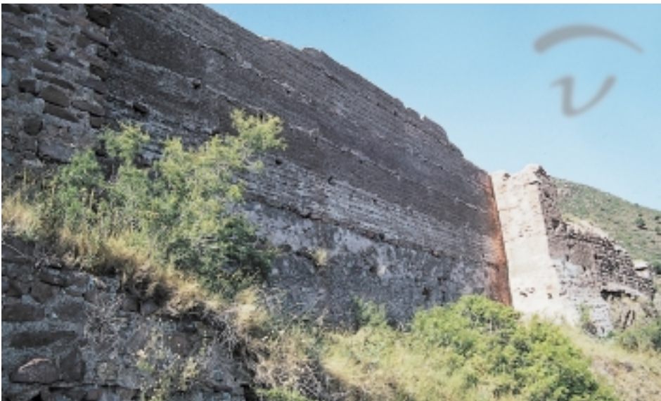
Foto 41. Restos de cal que aún son perceptibles en sus encofrados inferiores.
