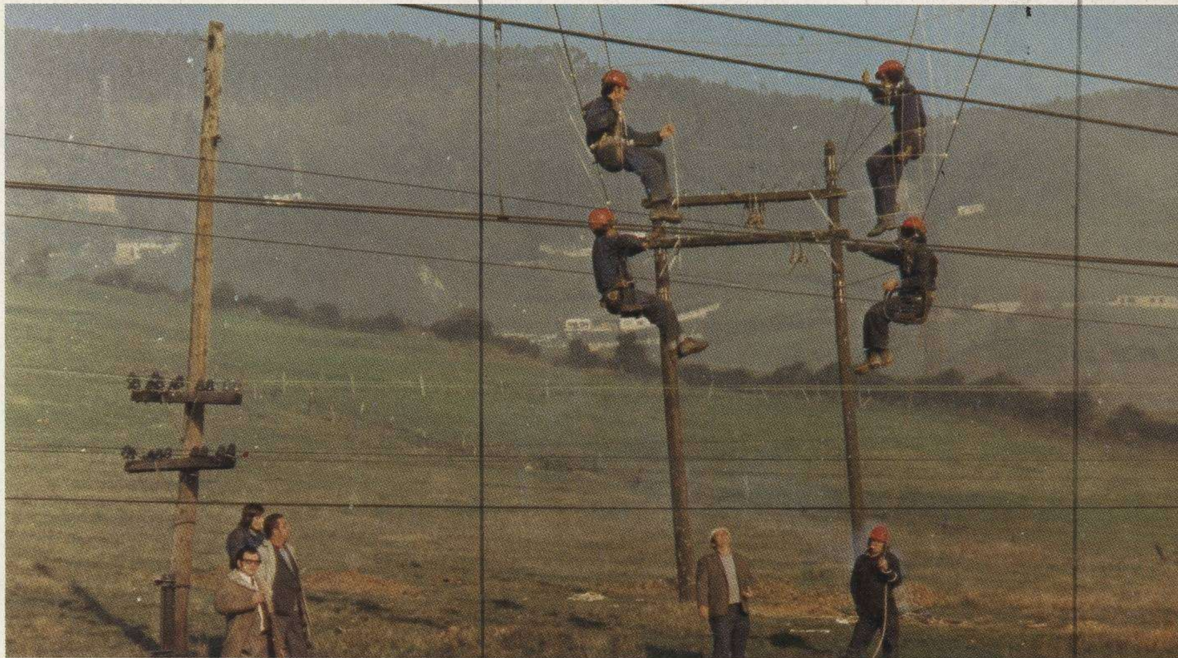
Cruce de línea aérea con el Ferrocarril de Asturias
