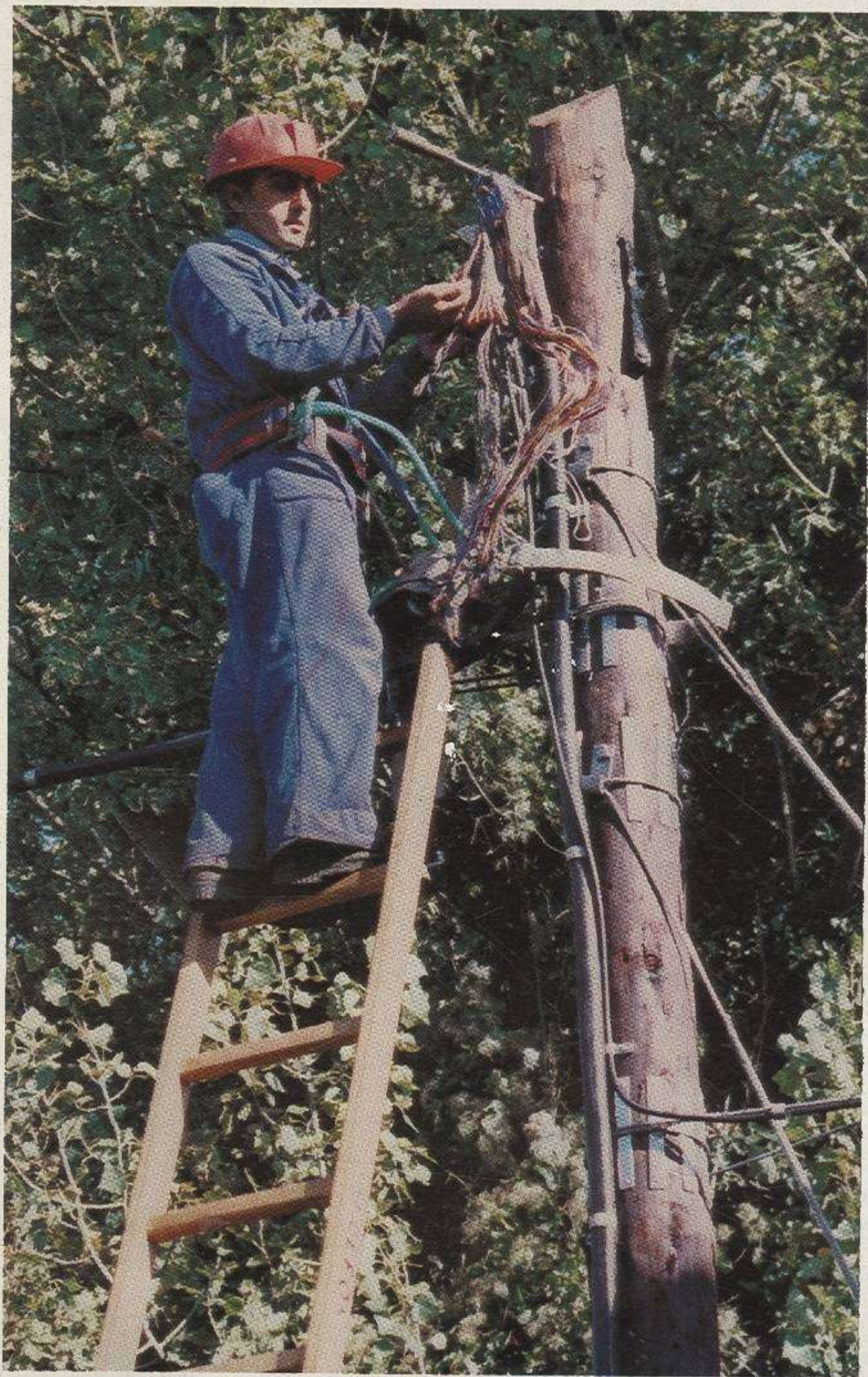
Empalme con cable aéreo
