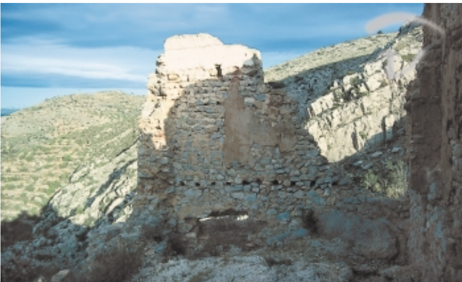
Foto 8. Detalle de su interior con las marcas de los apoyos de sus vigas.
