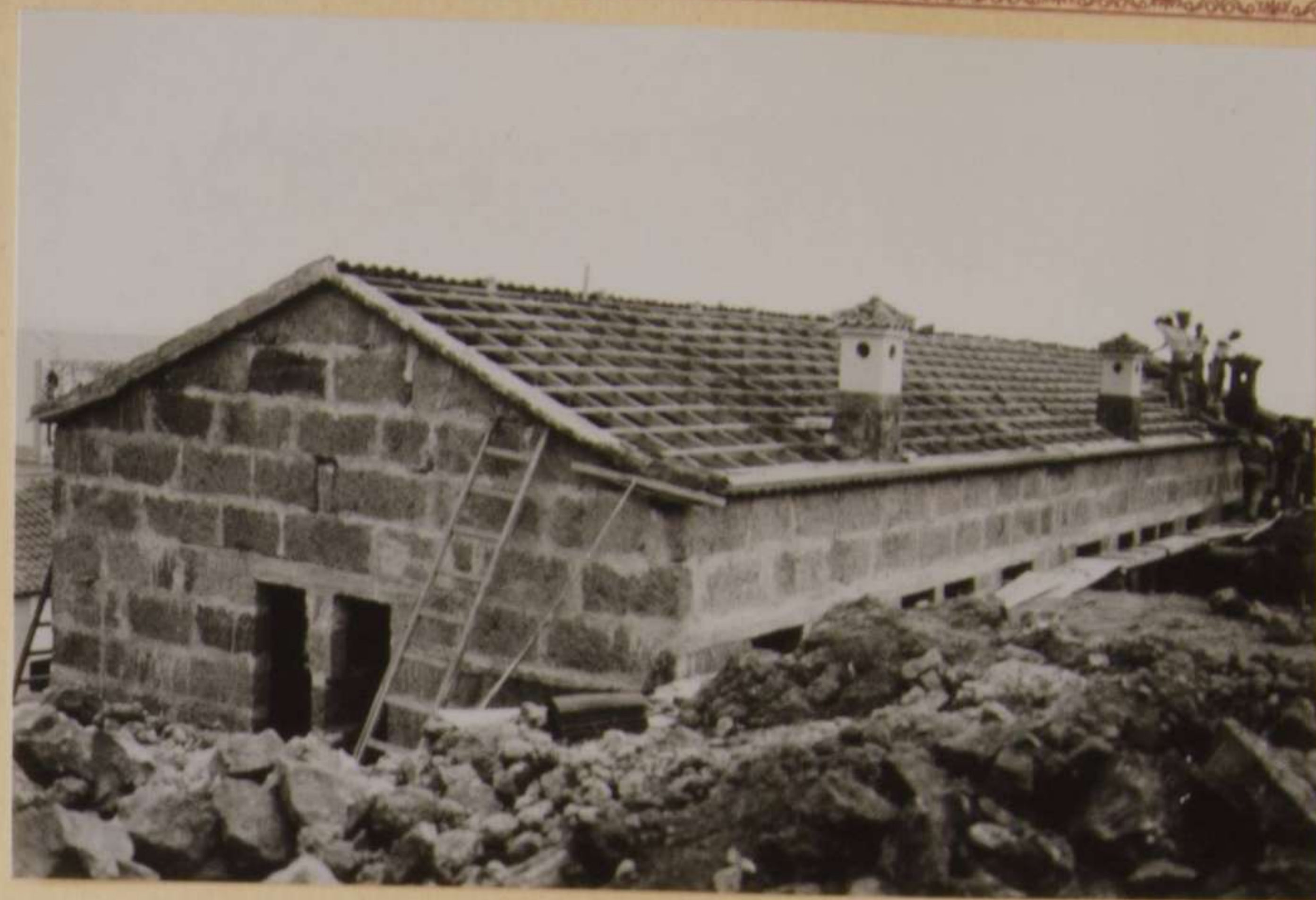
ESTADO ACTUAL DE LAS OBRAS DE AMPLIACION EN OCHO CASAS DE LA BARRIADA DE PESCADORES DEL PUERTO DE SAN MARCOS (ICOD) DONADAS POR EL M. E.
