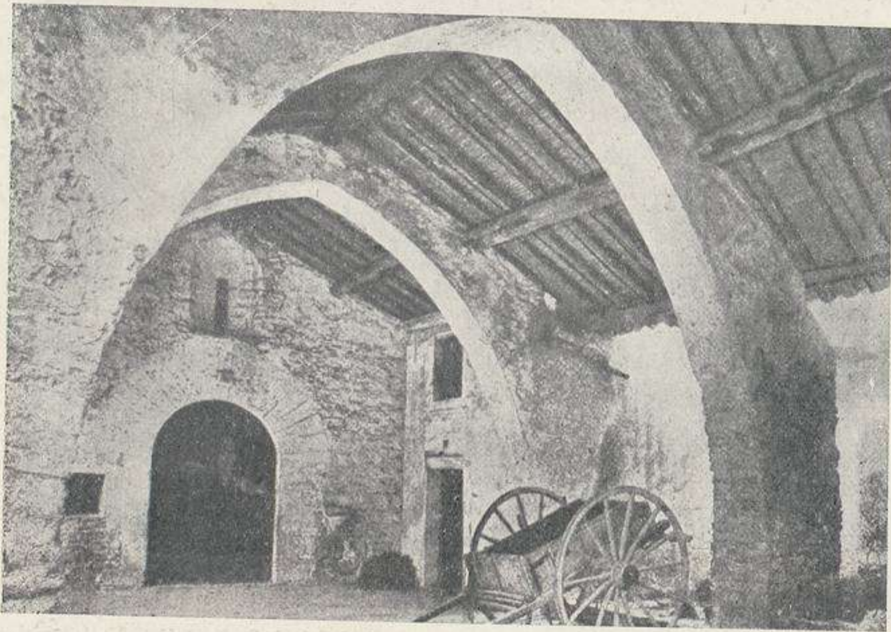
Argelaguer. — Pórtico de entrada a la ermita de Santa Magdalena de Montpalau (construída en el siglo XIII por Arnaldo de Sales)
