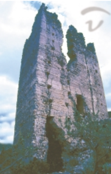
Foto 309. Vall de Almonacid. El peligro del tapial son las grietas o fisuras que presenta.
