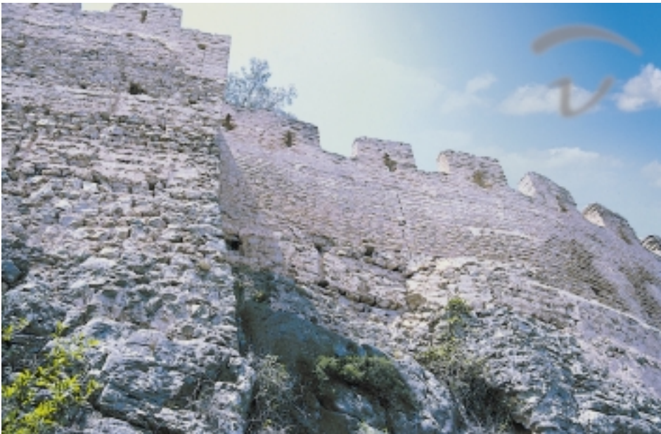
Foto 290. Corbera. En la construcción del tapial, el ladrillo se integraba a veces como un elemento más. Como se puede observar se colocaba de forma ordenada dentro del encofrado.
