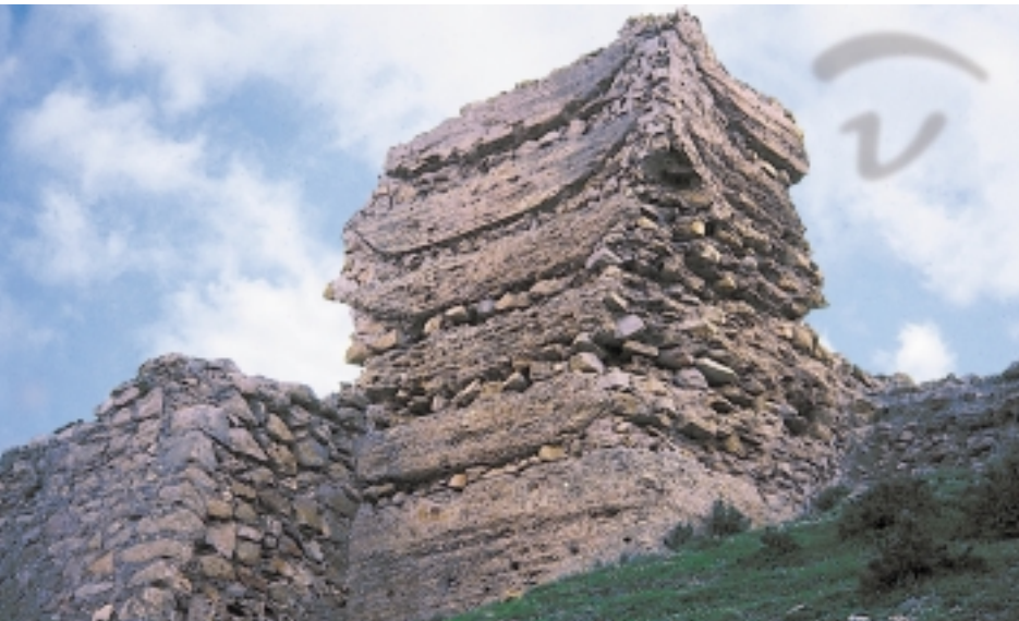
Foto 118. Detalle de su construcción en tapial que ha sufrido un gran deterioro.
