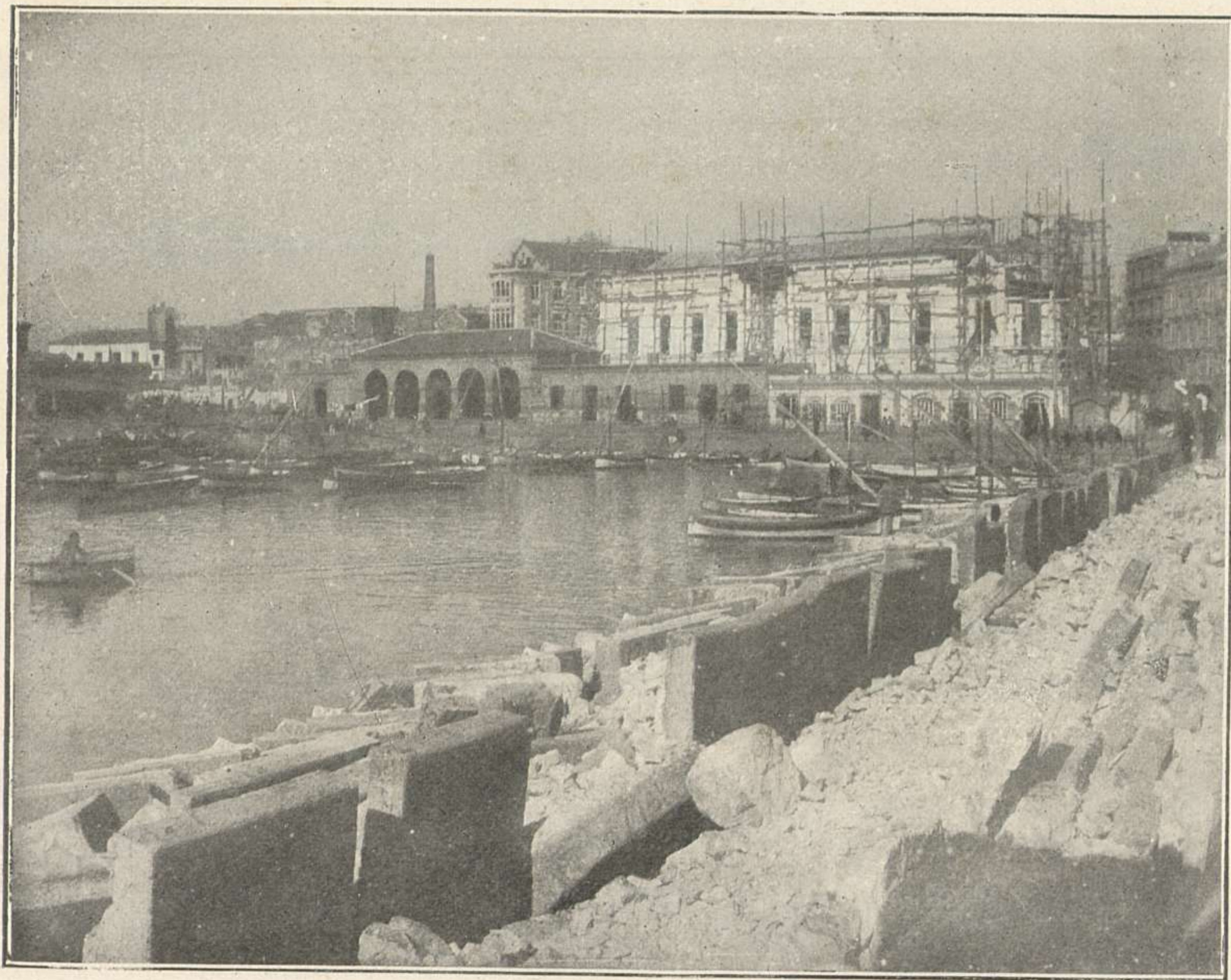
1905 - Obras preparatorias para el relleno de la antigua dársena de botes, para ser luego transformada en jardín. Al fondo el Palacio Municipal, en construcción.
